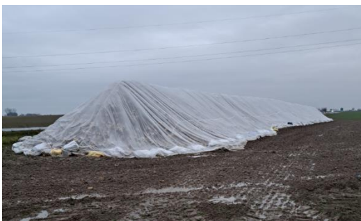
zastosowanie włókniny o niewłaściwej gramaturze (poniżej 110g/m 2 )
