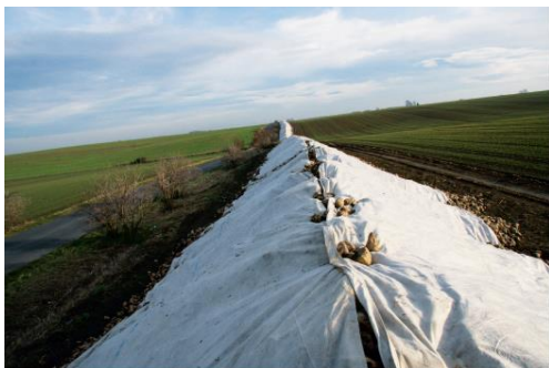
podstawa i wierzchołek nieokryte, zabezpieczone niewłaściwym materiałem (burakami)
